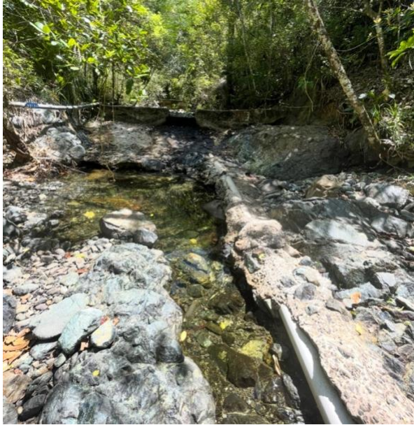
Figura 4 Tubería que recoge agua del río y la lleva al tanque de grava
