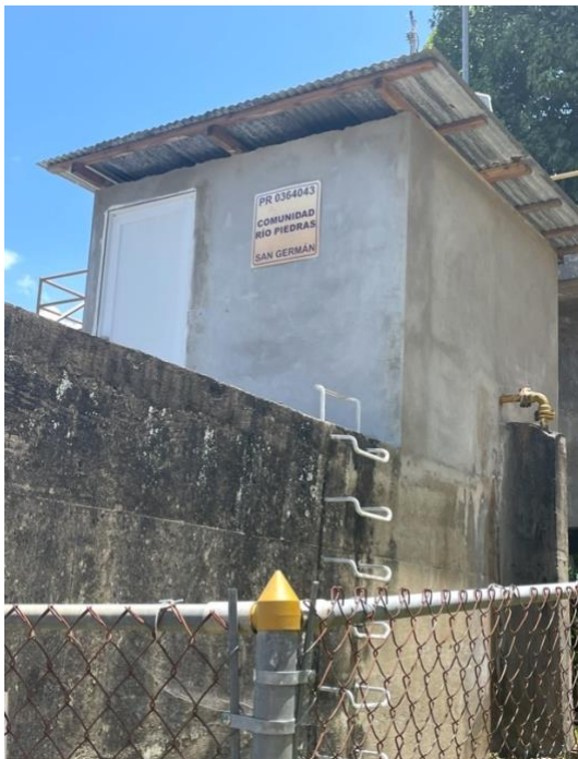
Figura 10 Cuarto de cloración y tanque de distribución
