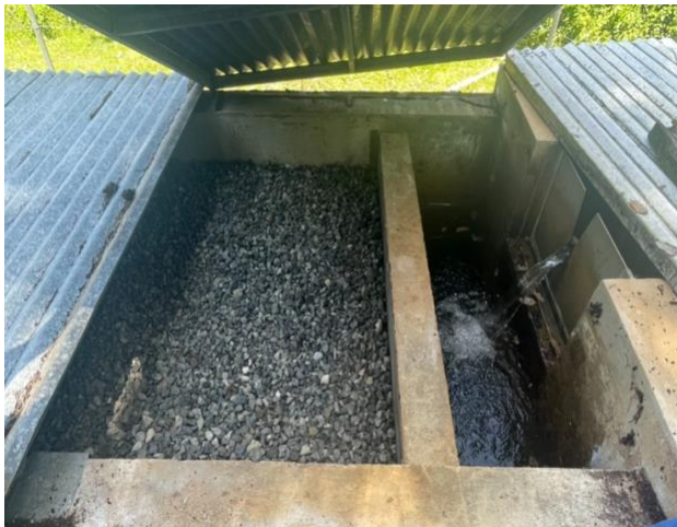
Figura 6 Entrada del agua cruda al taque de grava
