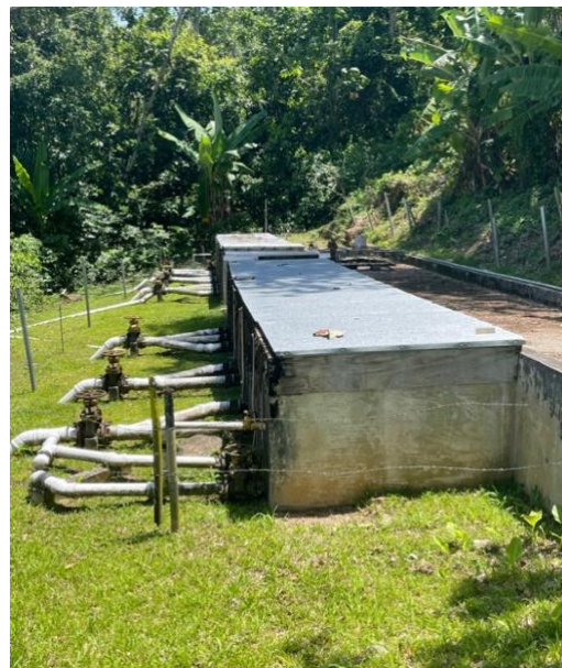
Figura 7 Tanques de grava
