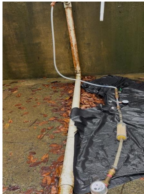
Figura 16 Ensamblaje con tubería, indicador de presión, filtro con muestra, y medidor de flujo
